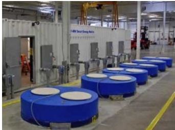
Central de Armazenamento de 20MW por Flywheels da Beacon Power, Stephentown, New York.
