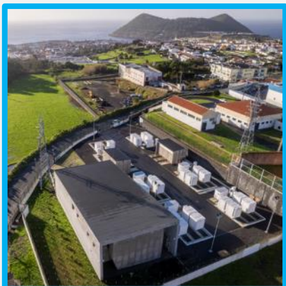
Instalação BESS da ilha Terceira
